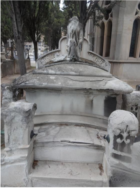
12. Panteó Rosita Torres en pèssim estat de conservació.
