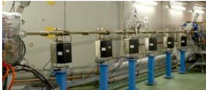
Fig 18. Vacuum chamber amb Ion Pumps
