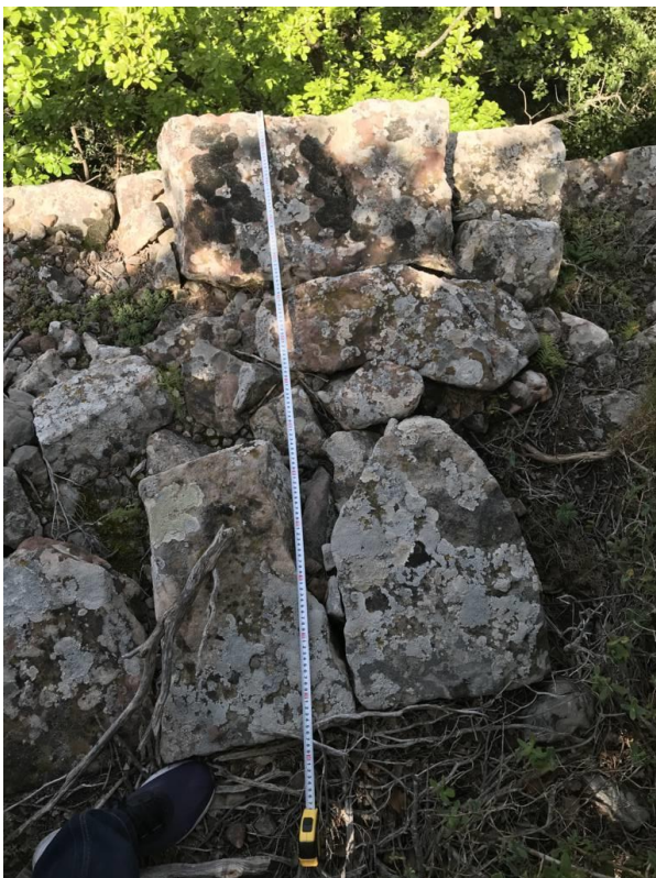
Imatge 31. Detall de les dimensions de la muralla que circumda la muntanya d'Escornalbou. Imatge digital de l'autor. 2021.
