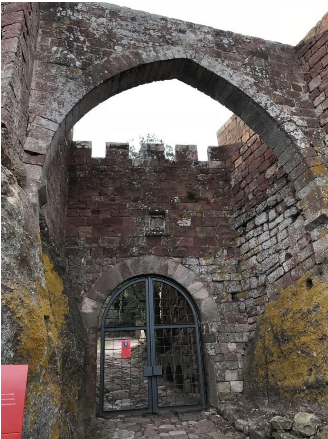
Imatge 12. Primer pla de les dues portalades d'entrada al Conjunt Monumental d'Escornalbou. Els dos estils arquitectònics es fusionen en un mateix punt. Mostra de l'eclecticisme arquitectònic que volgué donar Eduard Toda a l'emplaçament. Imatge digital de l'autor. 2017. Si no es revisen els horaris de visita, es pot trobar la porta d'accés tancada.
