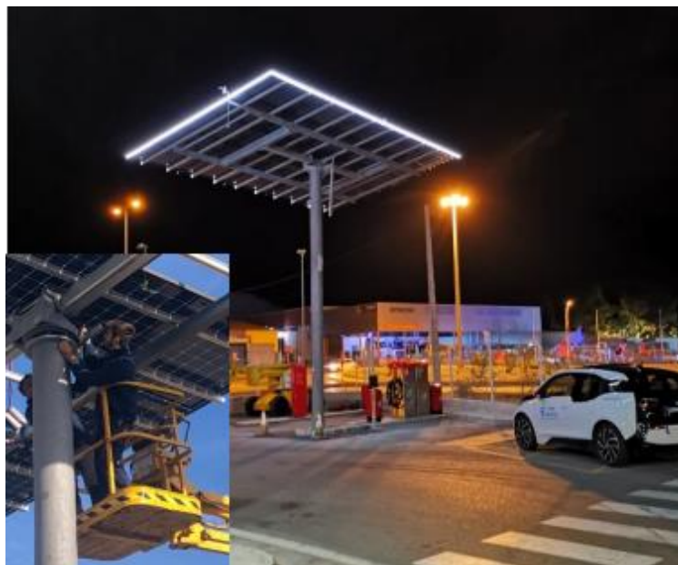
Figura 9. Electrolinera fotovoltaica de Huércal [21]
