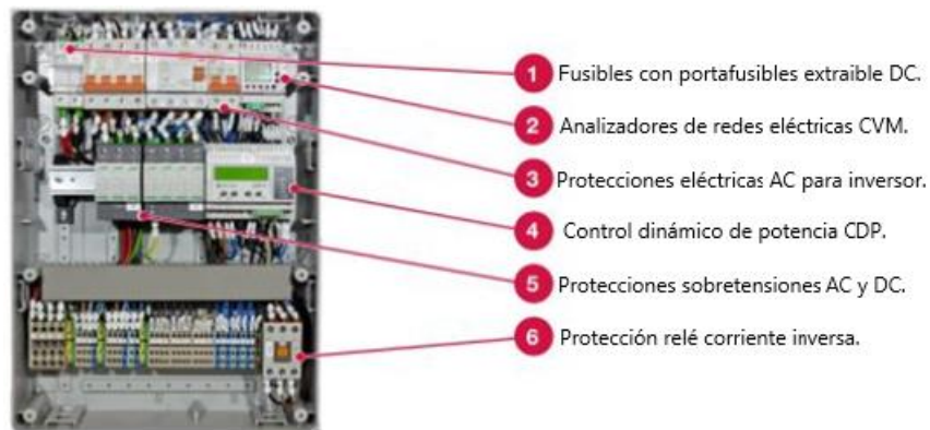
Figura 67. Combiner Box de la instalación [86]
