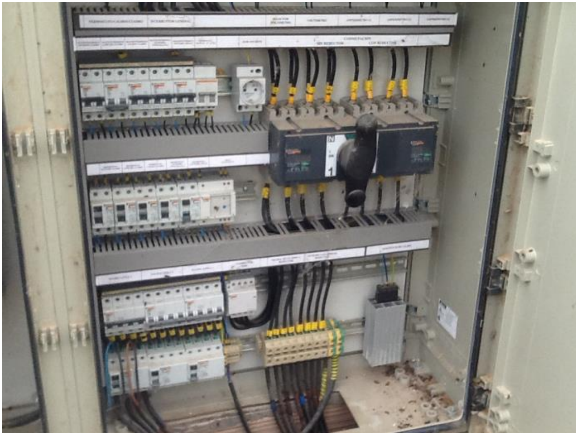
Imagen 3 - Interior del cuadro de mando ABLIC1. Fuente: Ayuntamiento de Ablitas
