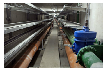
Figura 18. Imagen de una galería de servicios Fuente: Elaboración propia.
