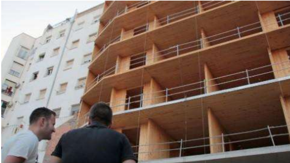
Imagen de la construcción de un edificio sostenible y modular en un solar cedido por el Ayuntamiento de Barcelona a cambio de un canon anual durante 75 años. Fuente: Ajuntament de Barcelona.
