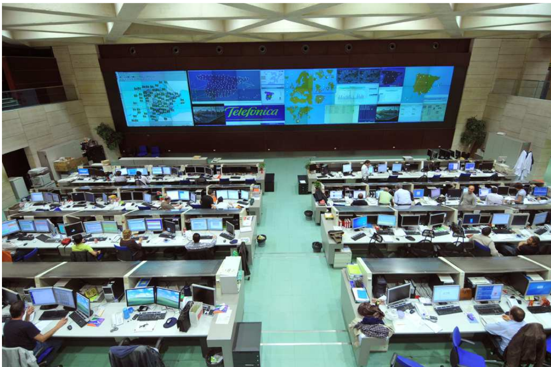
Figura 1 – Centro Nacional de Supervisión y Operaciones de Telefónica
