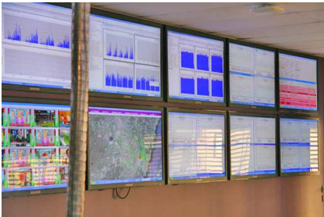
Figura 59 – NOC Vodafone Australia
