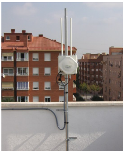
51. Ilustración: Soportación de equipo inalámbrico para muro
