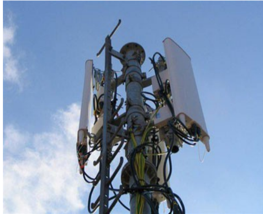
Figura 9. Estació Base (BTS)
