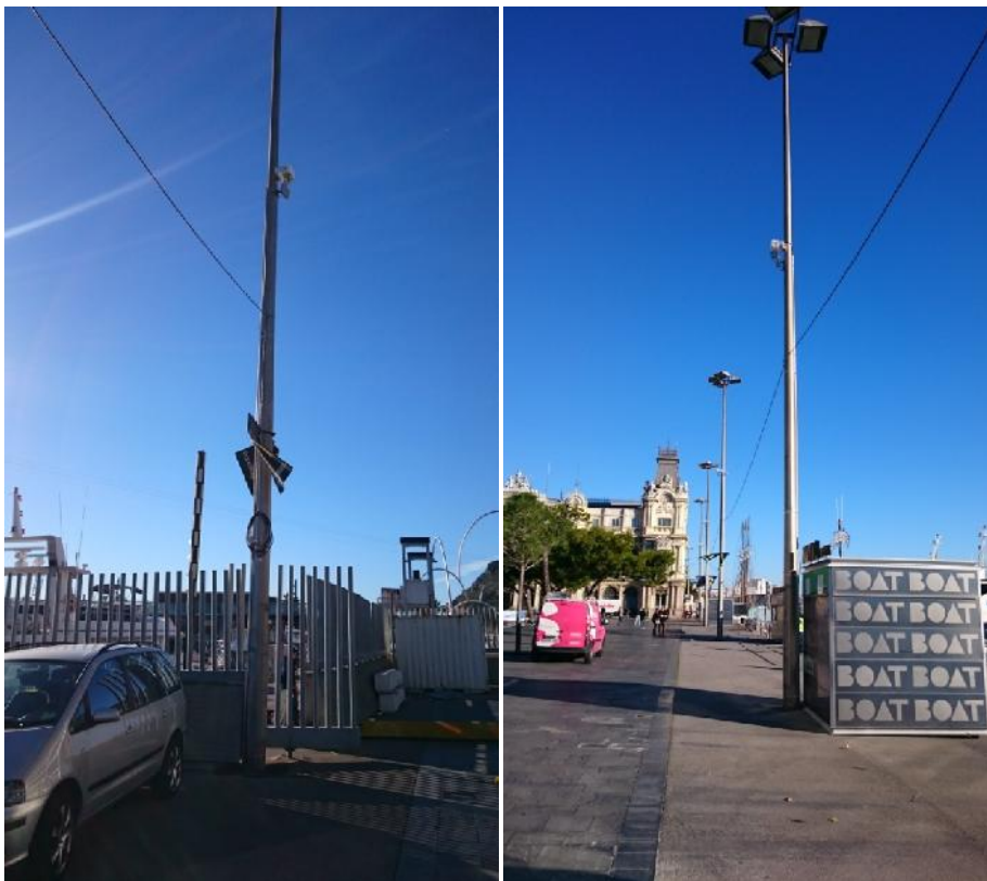
Imatge 18. Els 5 AP's instal·lats en la zona del Moll de les Drassanes en els 5 fanals un en cada fanal, en aquest punt tenim AP's orientats cap a montany i AP's orientats cap a Mar per oferir cobertura en la zona del Moll.
