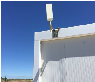
Figura 21: Ejemplo instalación antena exterior
