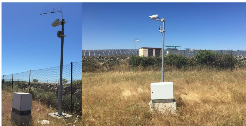
Figura 14: Ejemplo Instalación de cámaras sobre báculos y caja de conexión.
