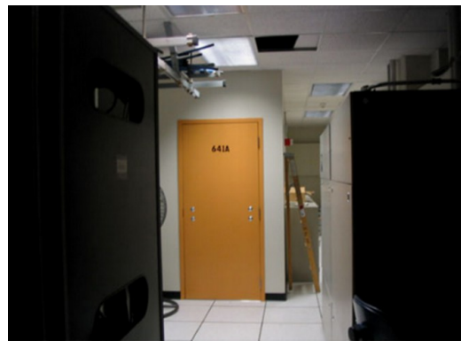
Fig. 3 – Habitación 641A, en una central de conmutación de AT&T de San Francisco (foto filtrada por Mark Klein)
