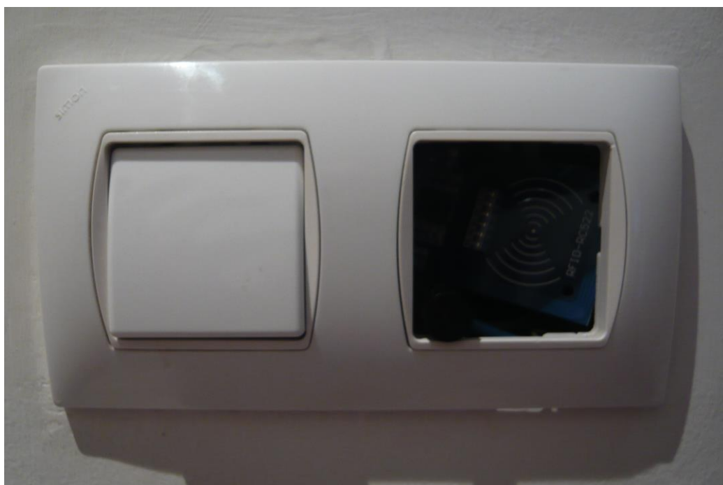
Il·lustració 33. Instal·lat a l'entrada de l'habitatge.
