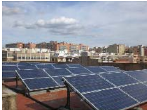
Exemple d'instal·lació fotovoltaica
