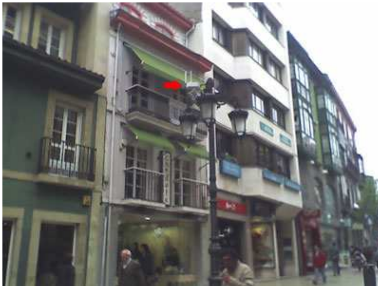
Figura 5 - Exemple de punt d'accés instal·lat en un fanal
