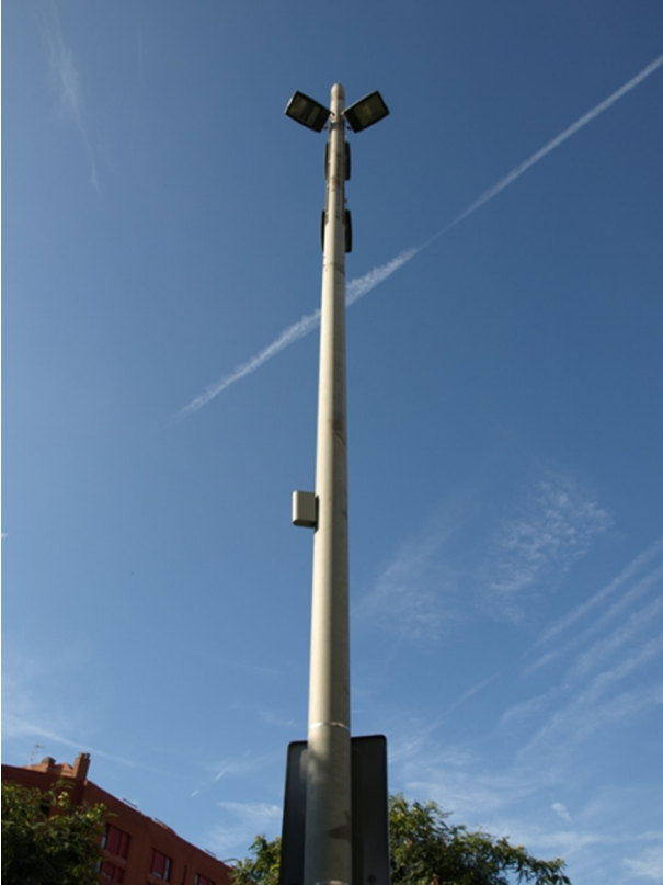
Figura 55. Enrutador U-Flag instalado en el mobiliario urbano.
