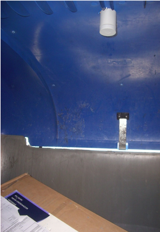
Figura 53. Sensor de Urbiotica instalado en un contenedor de papel.
