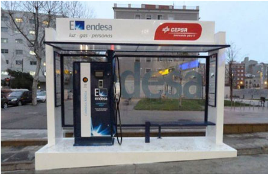
Figura 13. Primer punto público de recarga rápida CHAdeMO instalado en España, que se encuentra en el distrito 22@ de Barcelona.
