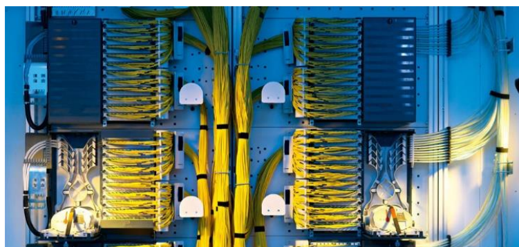
Il·lustració 4: Repartidor de fibra òptica. ODF
