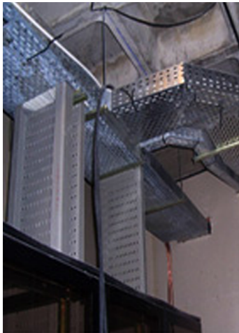
Ejemplo de canalización por bandejas desde un armario repartidor buscando el falso techo de la sala contigua.
