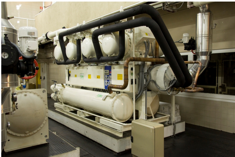
Planta enfriadora condensada por agua
