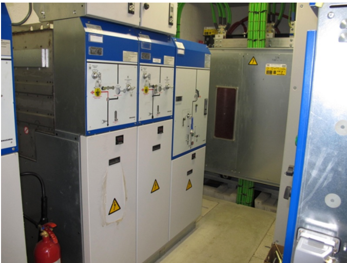
Celdas alta tensión
