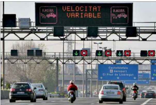
Figura 8. Paneles de señalización variable
