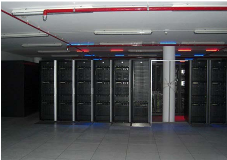
Sistema de extinción en un CPD
