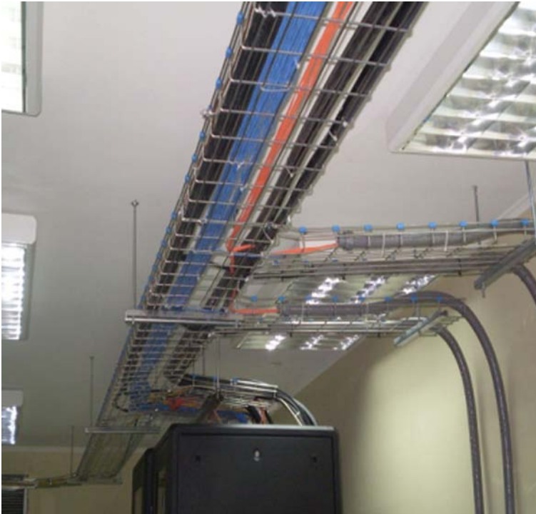
Ejemplo de canalización de cableado por bandejas desde un armario repartidor
