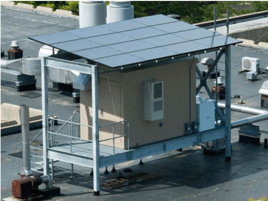
Figura 6. Fotografía del exterior del microcentro de datos Parasol en Rutgers, State University of New Jersey
