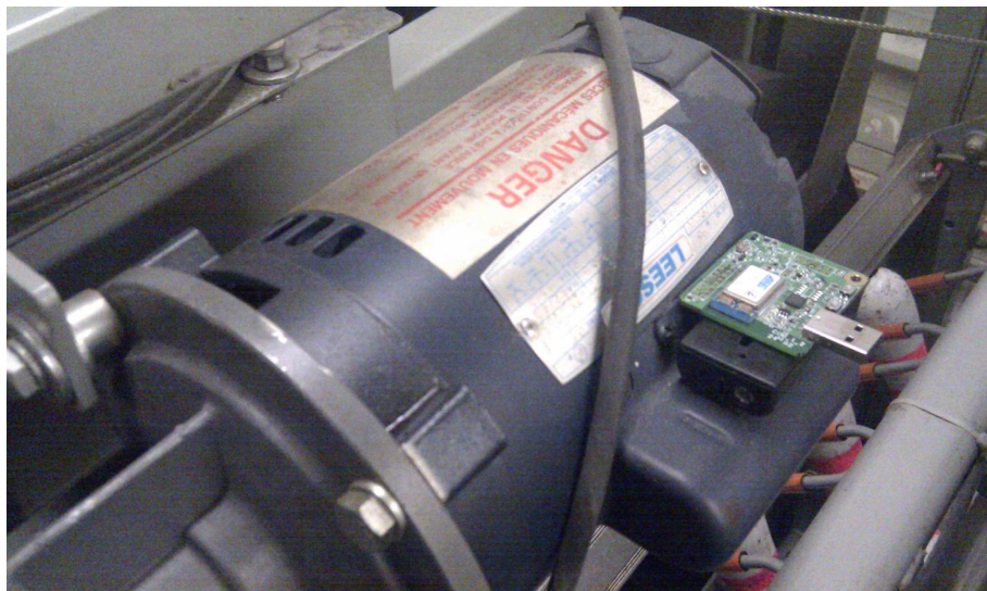
Imagen 14. Mota instalada en contacto con la carcasa de un motor.
