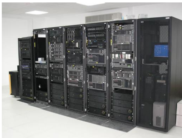
Figura 39: Sala de equipos [35]
