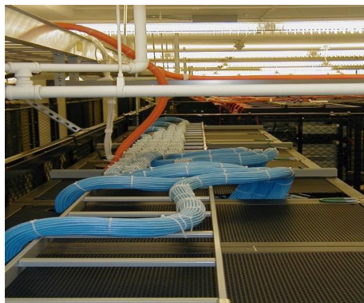
Ilustración 38 - Organización del cableado por encima de un rack
