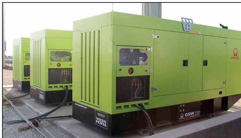
Ilustración 5 - Tres grupos electrógenos industriales
