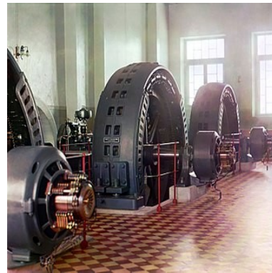
Figura 18. Alternador en una central hidroeléctrica. Extraída de [8].
