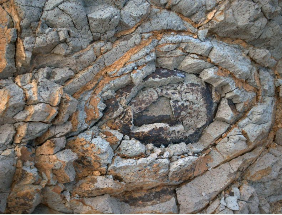
Figura 4. Roca meteoritzada per l'expansió tèrmica, on la fractura es localitza just on hi ha els materials més foscos (expansió diferencial)
