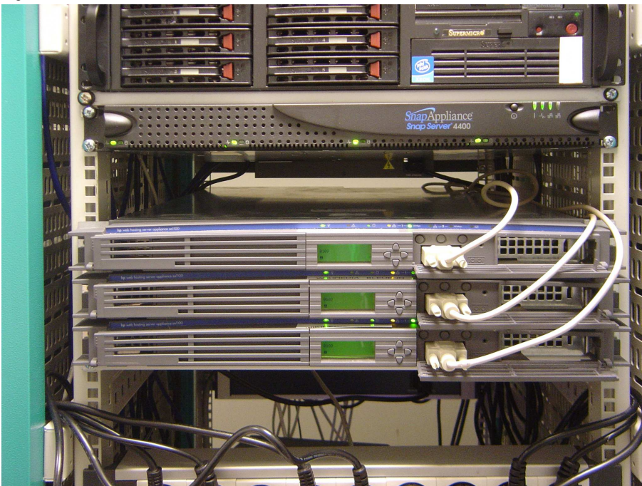
Figura 5. Servidores en un rack
