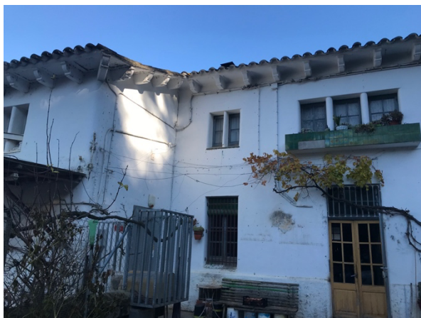
Imatge 4: Façana central Serinyà
