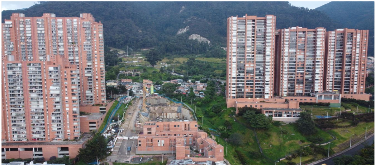
Figura 18. Foto del avance de obra del proyecto Fuente: Tomada por Andrés Serrano, septiembre 2021
