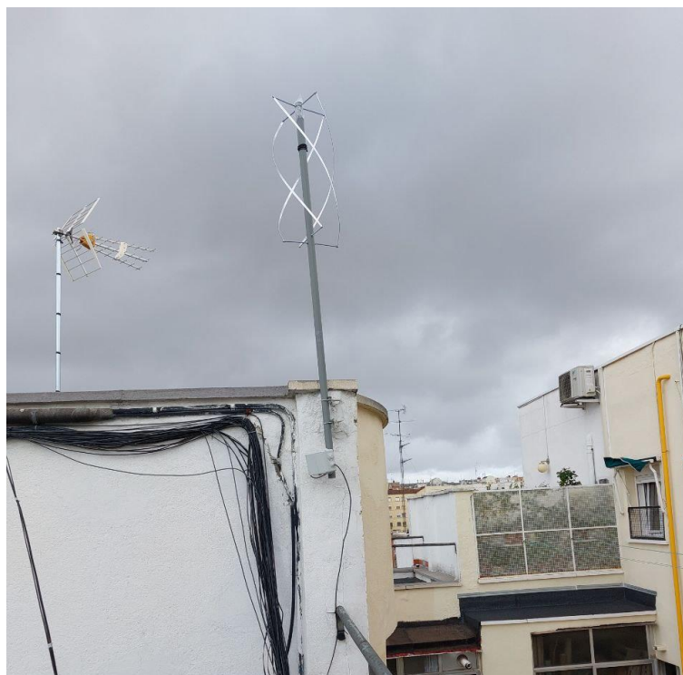
Figura 60. Instalación definitiva QFH
