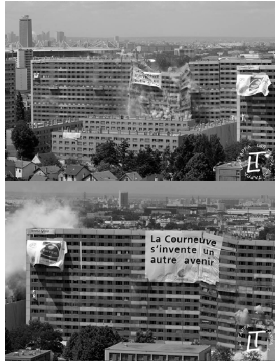
(08). Demolición del edificio Renoir en la cité des 4000 en el municipio de Courneuve (2000). Se aprecia la pancarta con «La Courneuve se inventa un futuro diferente» en la fachada del edificio.
