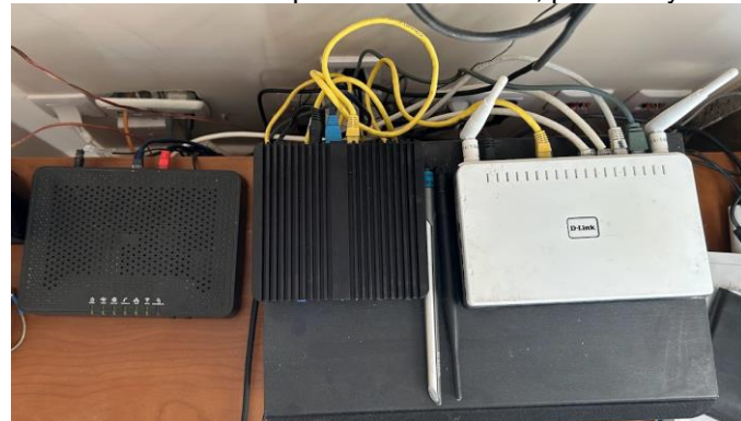
Figura 41: Vista cenital y de cableado de LiveBox+, pfSense y AP DDWRT.
