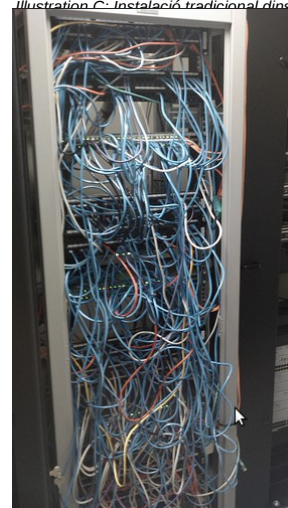
Illustration E: Cablejat de rack sense sanejar
