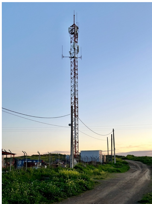
Figura 18. Fotografía II: emplazamiento de la BTS existente. [elaboración propia]
