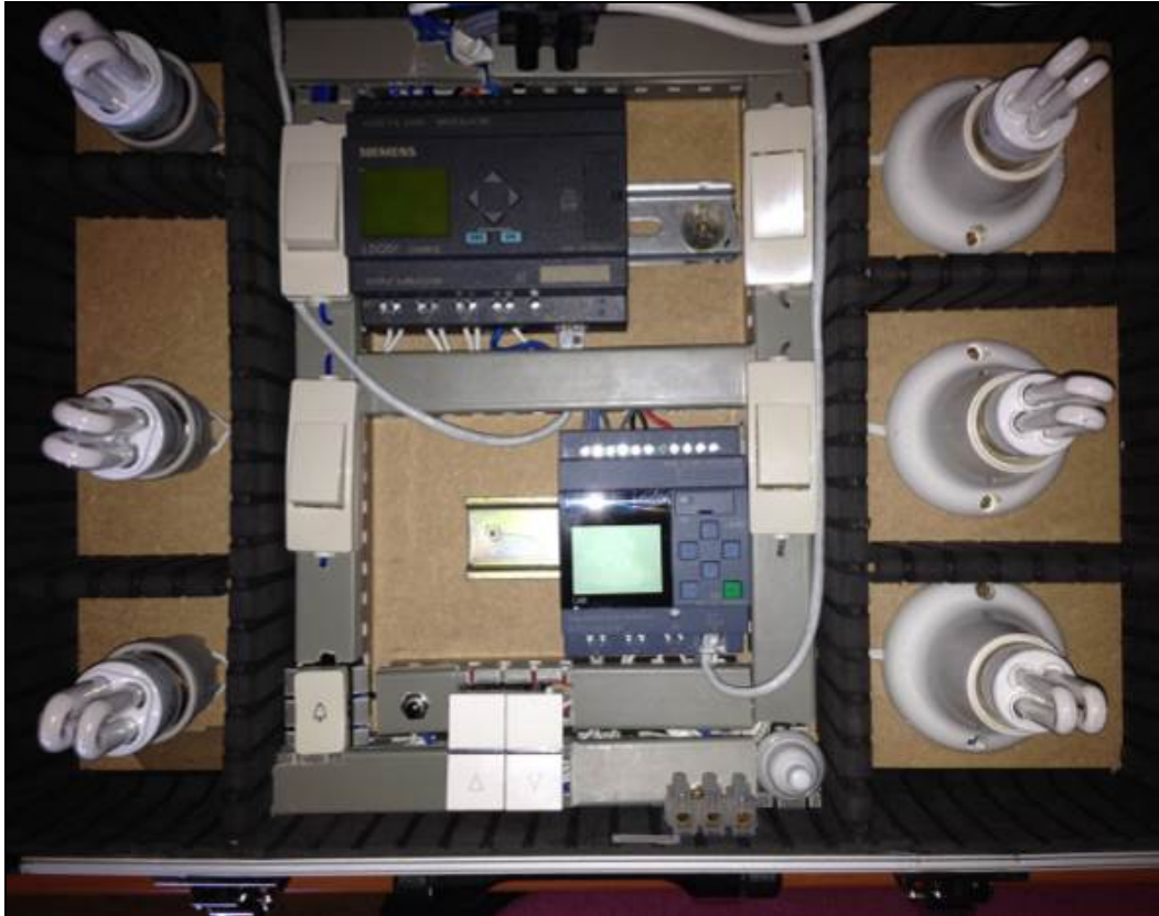
Ilustración 26. Prototipo cableado completo.
