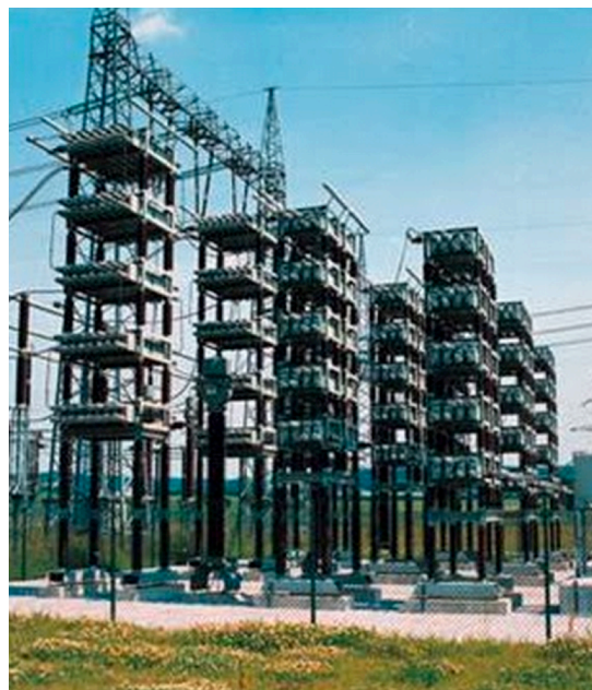
Figura 9.- Radiación bajas frecuencias provocada por líneas alta tensión.
