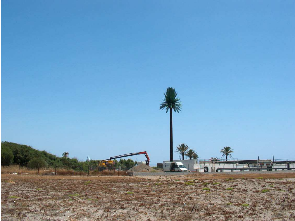
Figura 184. Torre tipo árbol (palmera). Provincia de Cádiz. Foto real.
