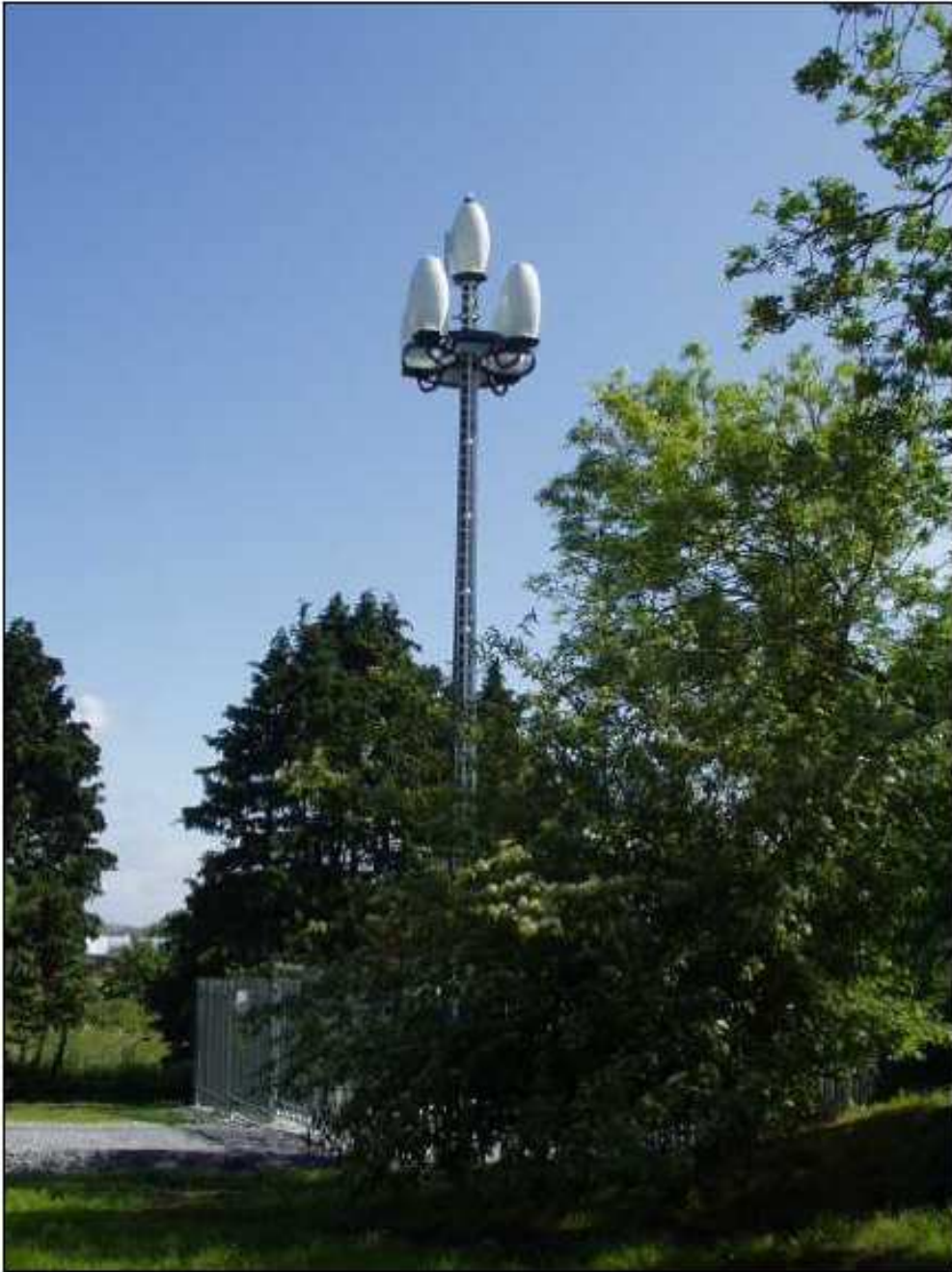
Figura 173. Torre de iluminación
