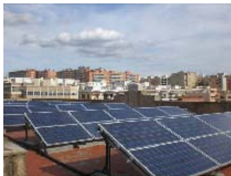
Ejemplo de instalación fotovoltaica
