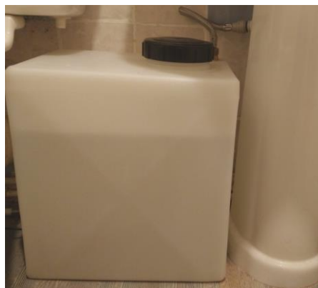
Figura 18. Tanc d'aigua instal·lat
