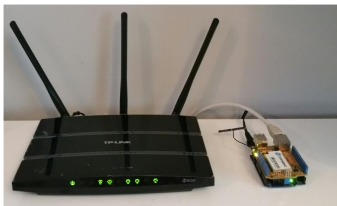
Ilustración 3: Instalación de Servidor Broker MQTT junto a switch doméstico
