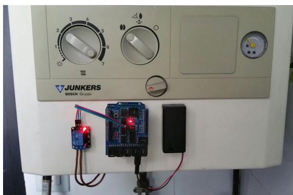
Ilustración 5: Instalación de sensor inalámbrico en caldera.
