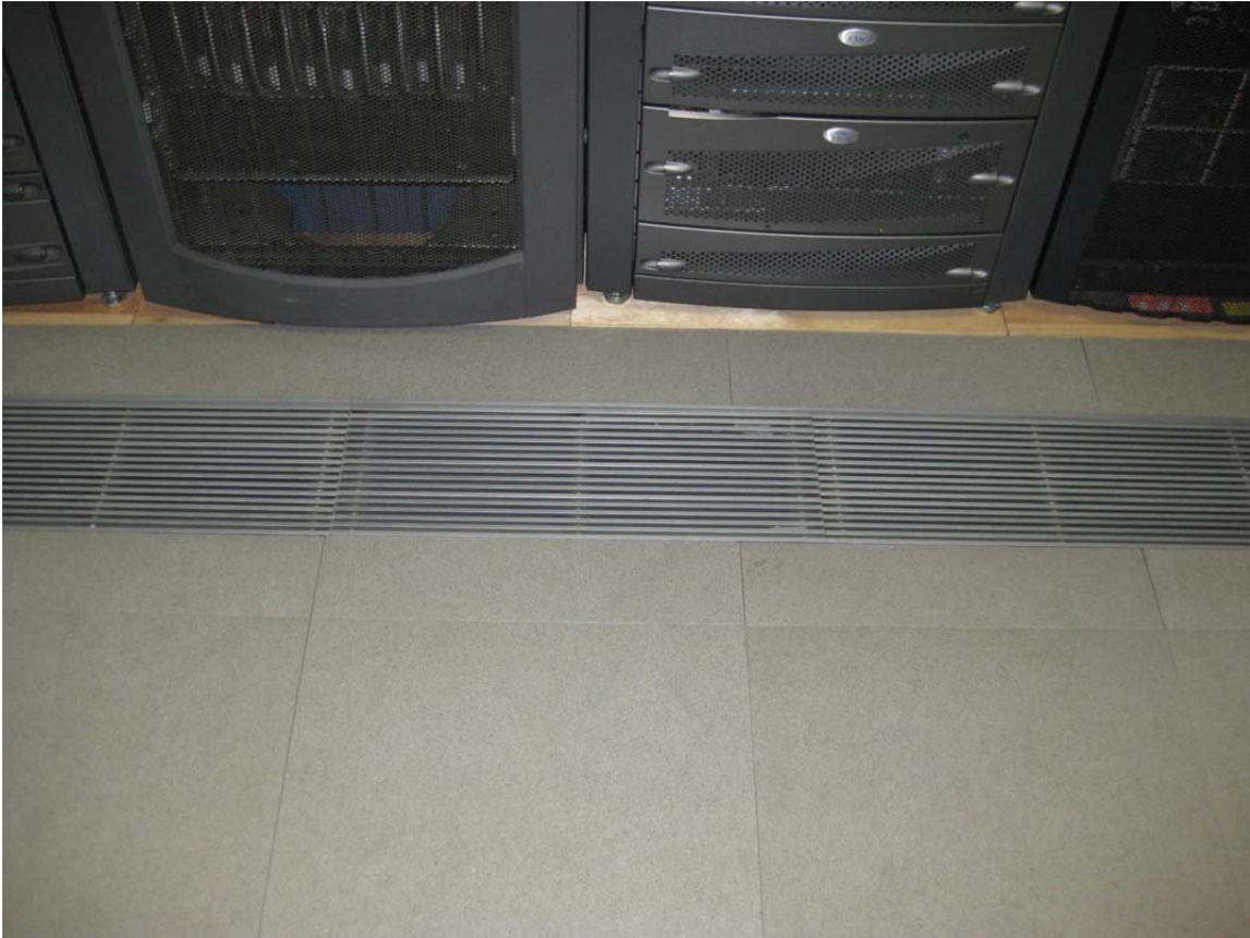
Ilustración 5-38. Detalle suelo sobre-elevado en sala de servidores
