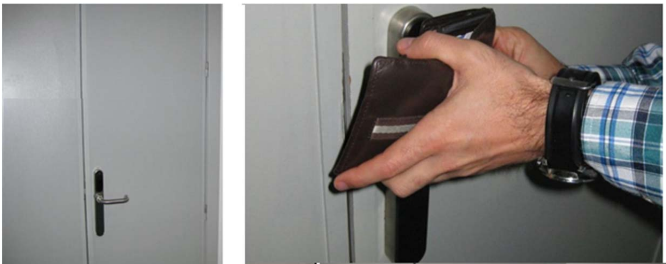
Ilustración 5-27. Control de acceso a salas mediante tarjeta RF
