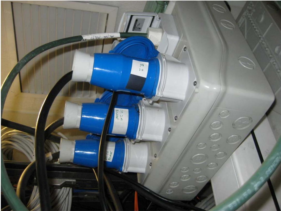
Ilustración 5-31. Detalle de suministro eléctrico en CPD
