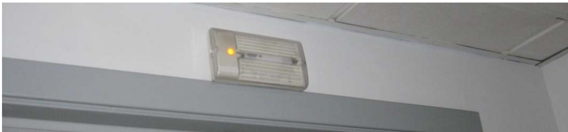
Ilustración 5-36. Luz de emergencia en salas
