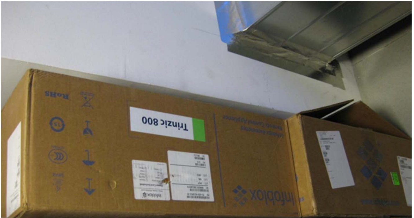
Ilustración 5-30. Detalle de embalajes de cartón en sala de comunicaciones
