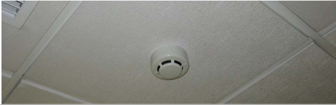
Ilustración 5-32. Detector de humo en sala de servidores
