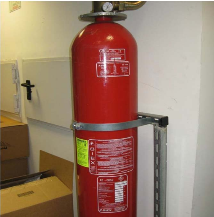
Ilustración 5-35. Sistema de extinción sala de comunicaciones
