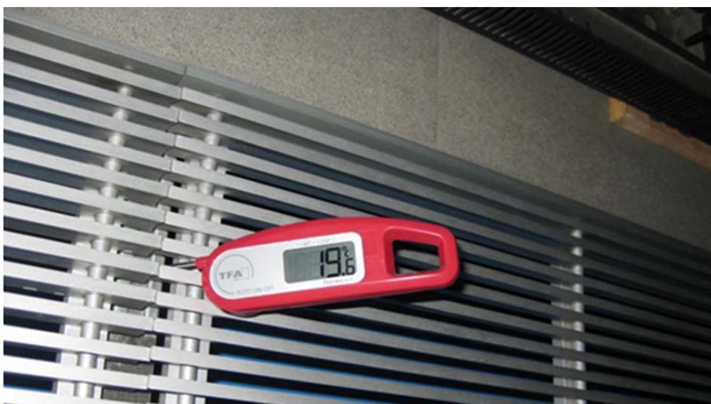
Ilustración 5-29. Medida de temperatura en sala de servidores
