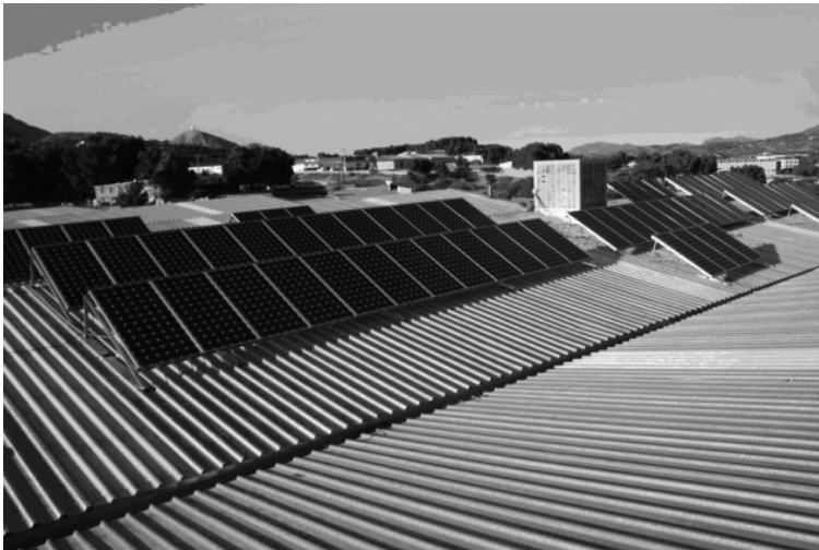
Figura 41. Plaques fotovoltaiques en coberta amb sistema de suport
