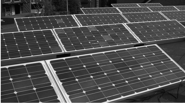
Figura 42. Instal·lació solar fotovoltaica sobre el terreny i fixa
