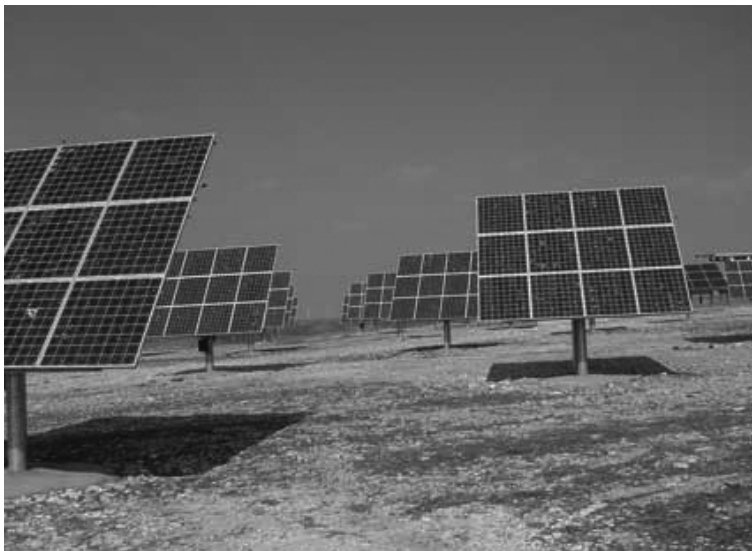
Figura 43. Instal·lació solar fotovoltaica sobre el terreny amb seguidors
