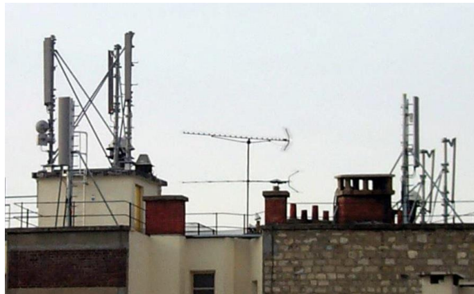
Il·lustració 10. Antenes panell de telefonia mòbil al terrat d'un edifici. X. Lagrange "4G Network Essentials", Institut Mines-Télécom (Course Slides), 2018.
