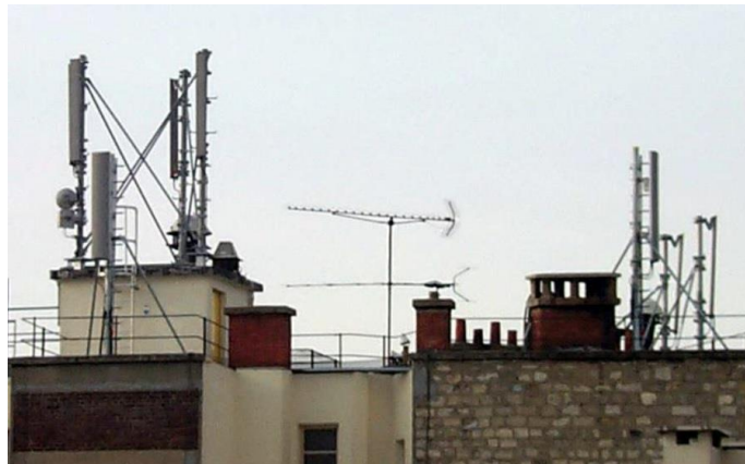
Il·lustració 10. Antenes panell de telefonia mòbil al terrat d'un edifici. X. Lagrange "4G Network Essentials", Institut Mines-Télécom (Course Slides), 2018.
