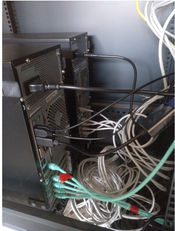
Figura 74: Connexions dels Hipervisors al RACK principal
