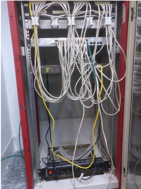
Figura 41: RACK Aula Informàtica
